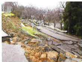
穴水高校（通学路崩落）
